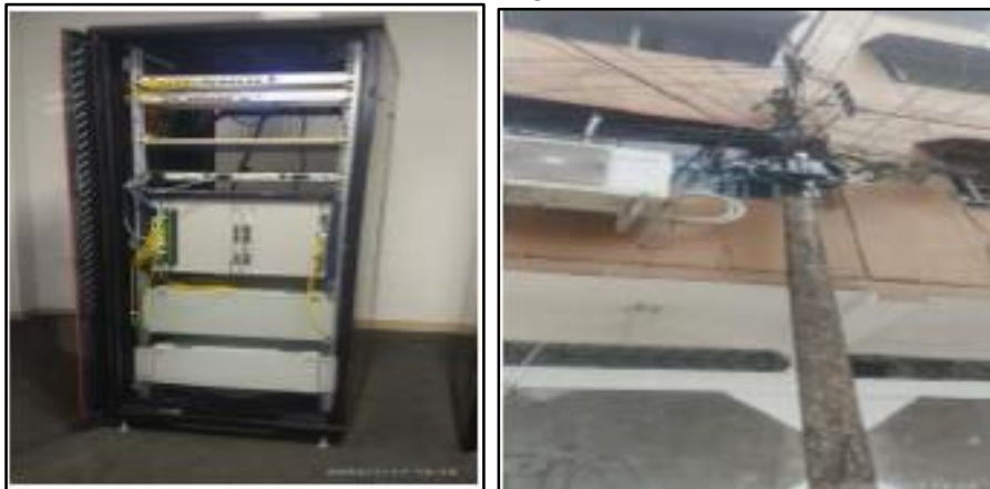
Gráfico N° 4 Gabinete con equipamiento del nodo TIPC y Splitter óptico 1x16 instalado en poste de energía.
