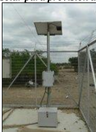
Gráfico 4.5: Panel solar para provisión de energía eléctrica.
