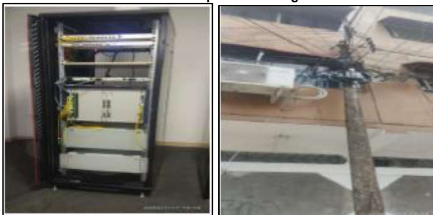
Gráfico N° 3 Gabinete con equipamiento del nodo de Perú Connections y Splitter óptico 1x16 instalado en poste de energía.
