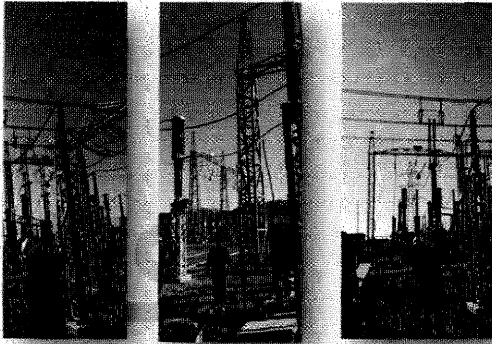
Fig. 49 – Verificación Ausencia de tensión en Subestaciones Zona de trabajo
