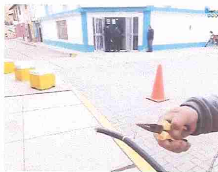
Alistamiento de cable – Desprendimiento de chaqueta
