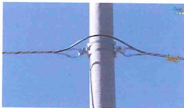
Herraje de retención instalado
