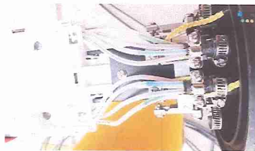
Sujeción del cable de Fibra Óptica
